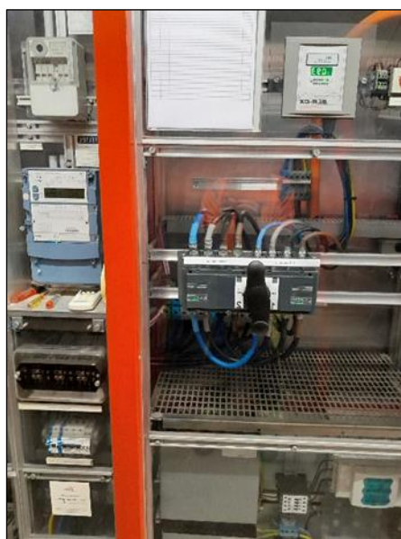
Inverseur de source du tableau électrique
