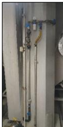
Vanne et clapet du dessableur
