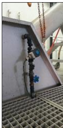
Vanne de clapet du dégrilleur
