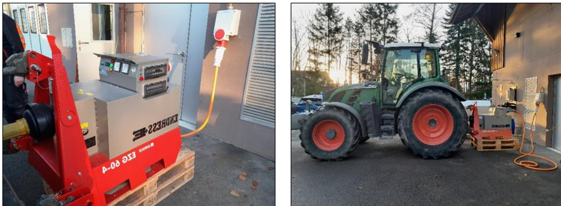
Génératrice 60 KVA, 48 KW, courant nominal 86 ampères
